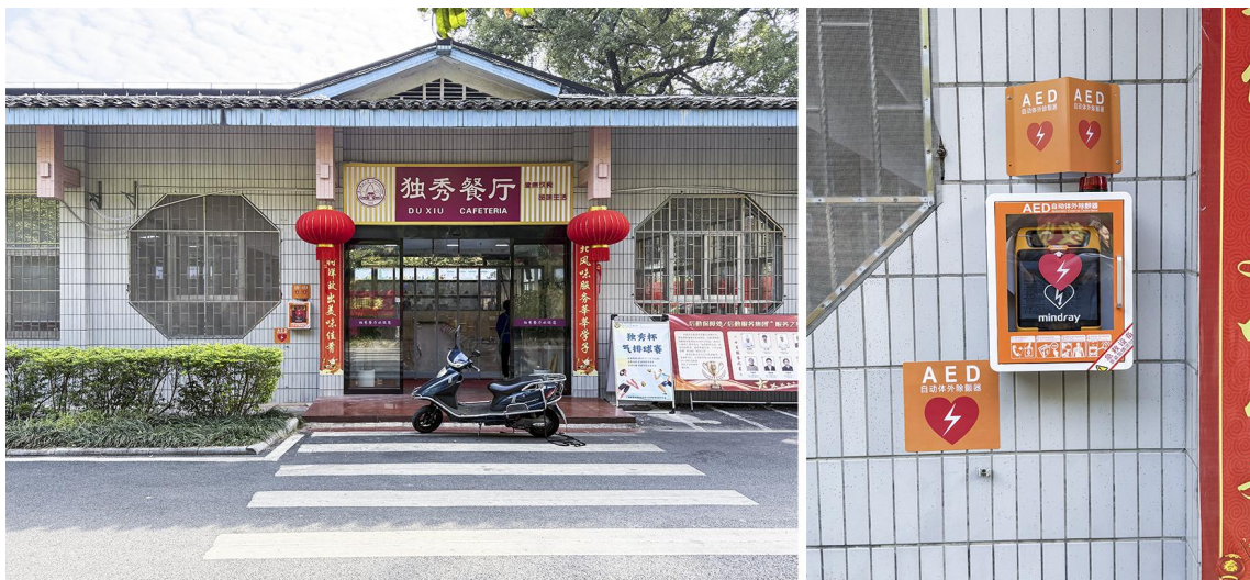
王城校区独秀餐厅 AED 安装位置现场图
