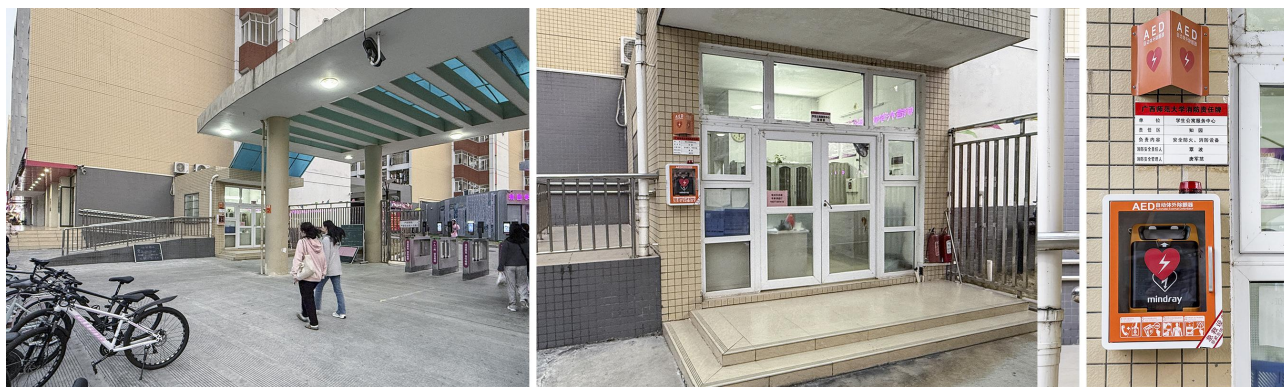
雁山校区知园（五期学生公寓）AED 安装位置现场图
